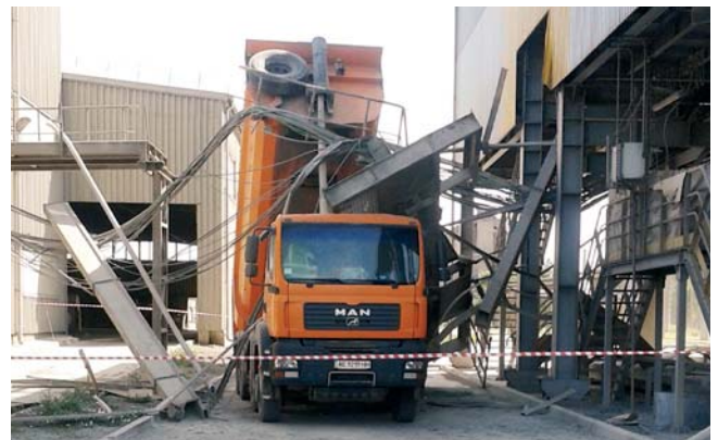
Рис. 2. Взаємне положення самоскида й естакади після аварії
