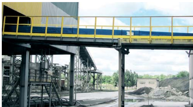
Рис. 1. Загальний вид естакади до події
