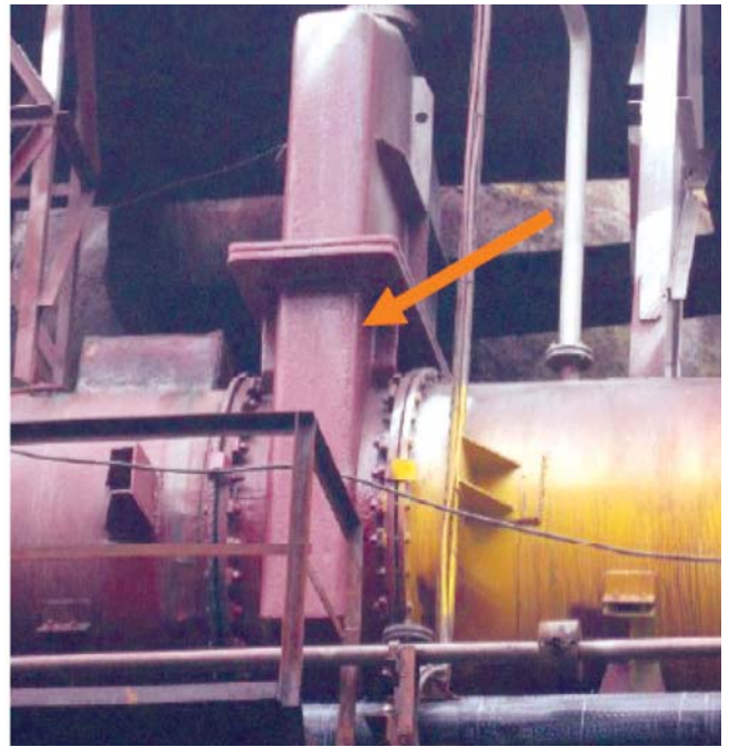
Рис. 8. Засувка на трубопроводі коксового газу з електричним і ручним приводами
