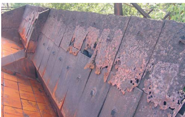
Рис. 7. Стан футеровки гасильного вагона після аварії
