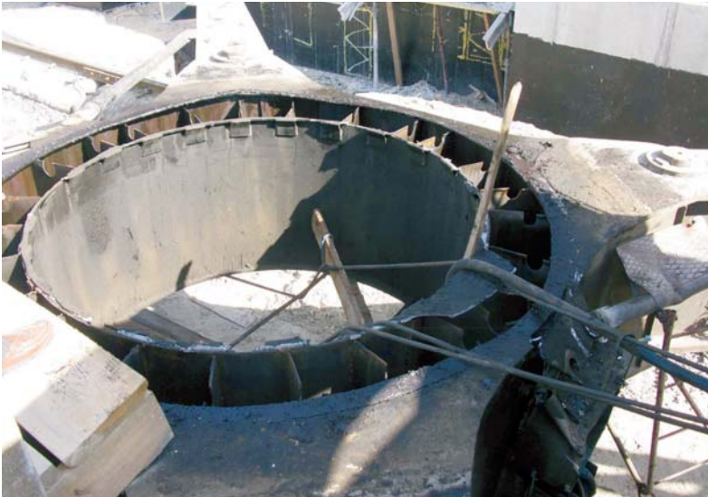
Руйнування верхнього листа ходової рами. На внутрішній обичайці видно посилення зварного з'єднання верхнього листа внутрішньої обичайки за допомогою 24 пластин (м. Київ)
