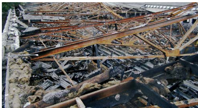
Рис. 14. Завалена будівля пташника
