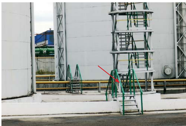
Рис 20. Обвалування виконано правильно, є перехідні містки
