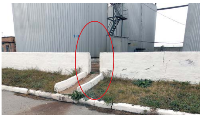
Рис 21. Обвалування виконано неправильно
