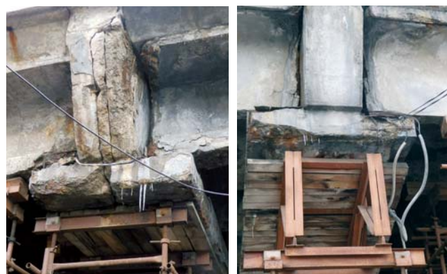
Рис. 23, 24. Розшарування бетону горизонтальних балок і опор шляхопроводу
